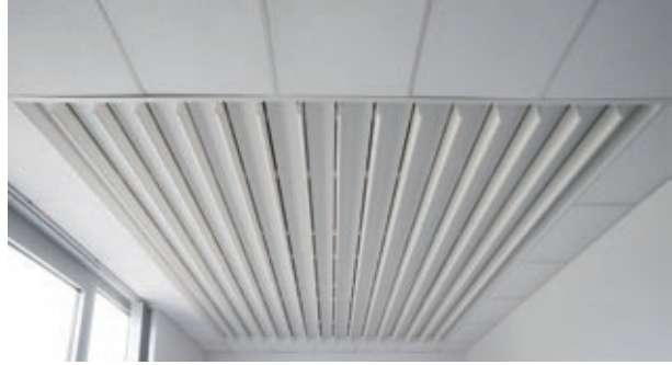
Bild 5: Büroraum mit PCM-Kühldeckenfeld
