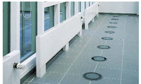
NTK floor twist outlet in a corridor at Gruner und Jahr AG & Co. KG, Hamburg / D
